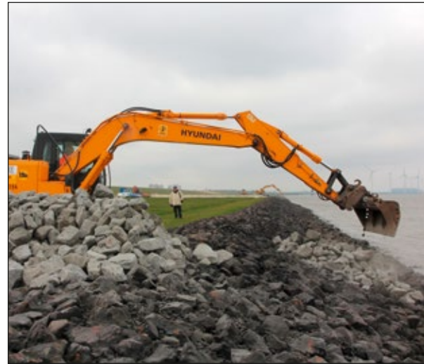
Verlust naturnaher Uferlebensräume durch Steinschüttungen
