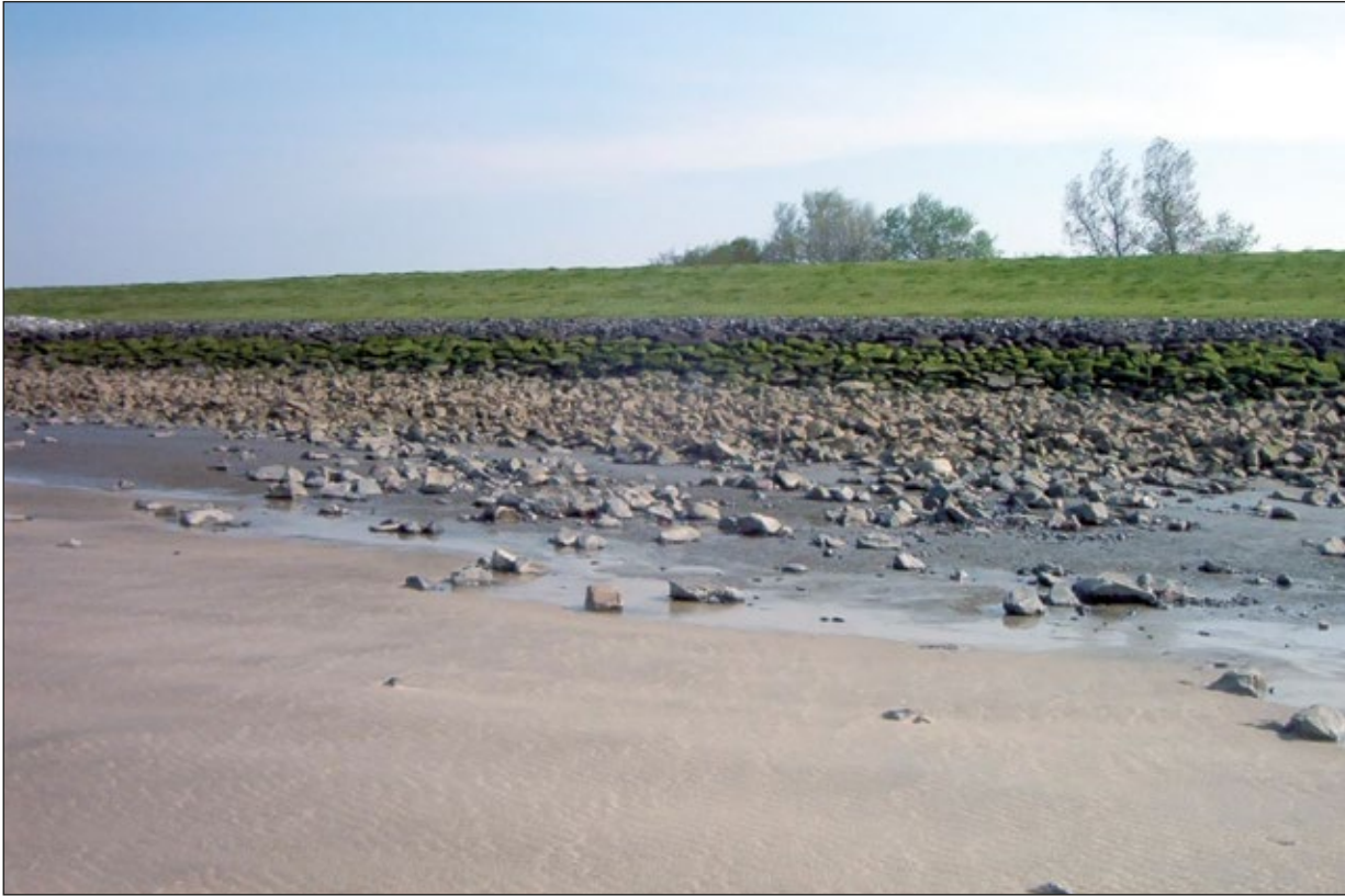
Schäden am Deckwerk im Altenbrucher Bogen an der Elbe
